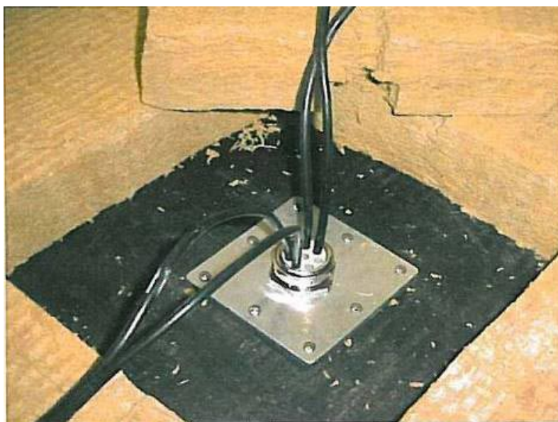
Figure 5 - Photos de la traversée de câbles
