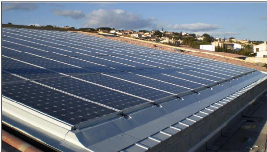
Figure 1 - Photo d'une installation raccordée utilisant les panneaux photovoltaïques PV XLight
